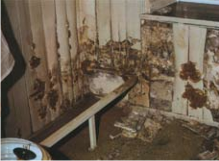
Bild 1: Echter Hausschwamm in Holzverkleidung
