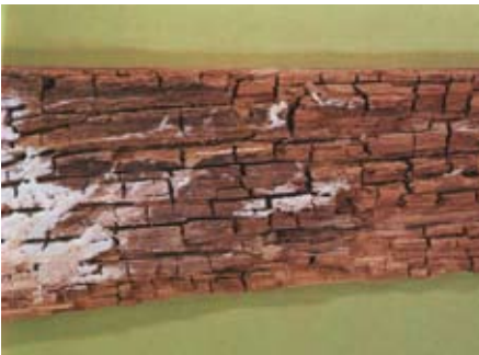
Bild 3: Porenschwamm in Holzbalken
