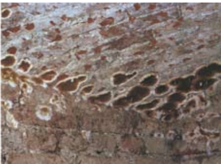
Bild 2: Echter Hausschwamm in Mauerwerk
